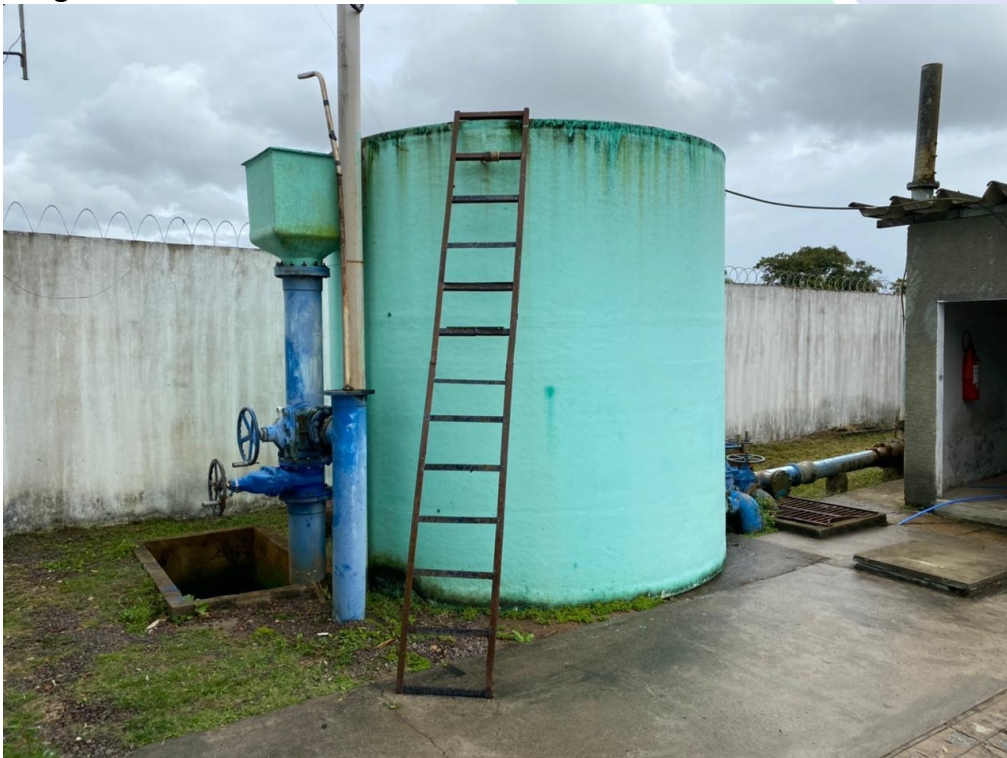
Imagem 2: Filtro da ETA.
