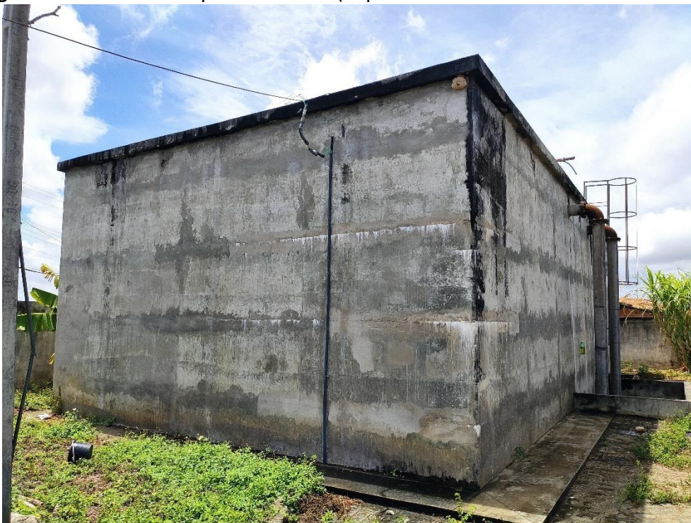
Imagem 1: Reservatório Apoiado – Sede (Capacidade de armazenamento de 500m 3 ).
