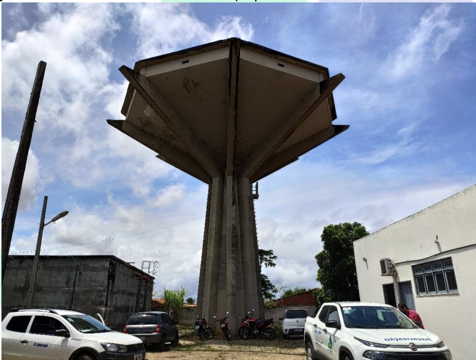
Imagem 2 – Reservatório Elevado – Sede (Capacidade de armazenamento de 100m 3 ).
