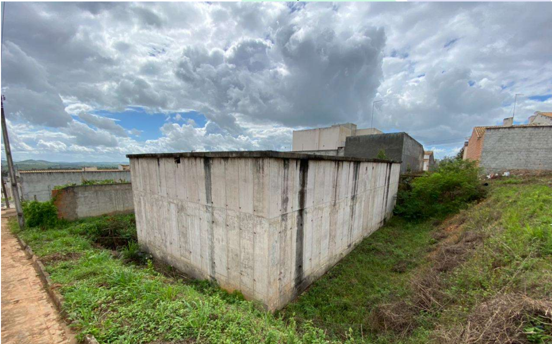
Imagem 2: Reservatório Apoiado que irá compor o sistema de abastecimento de água do município.
