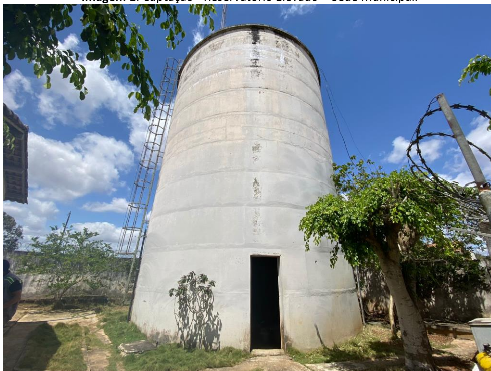
Imagem 1: Captação - Reservatório Elevado – Sede Municipal.
