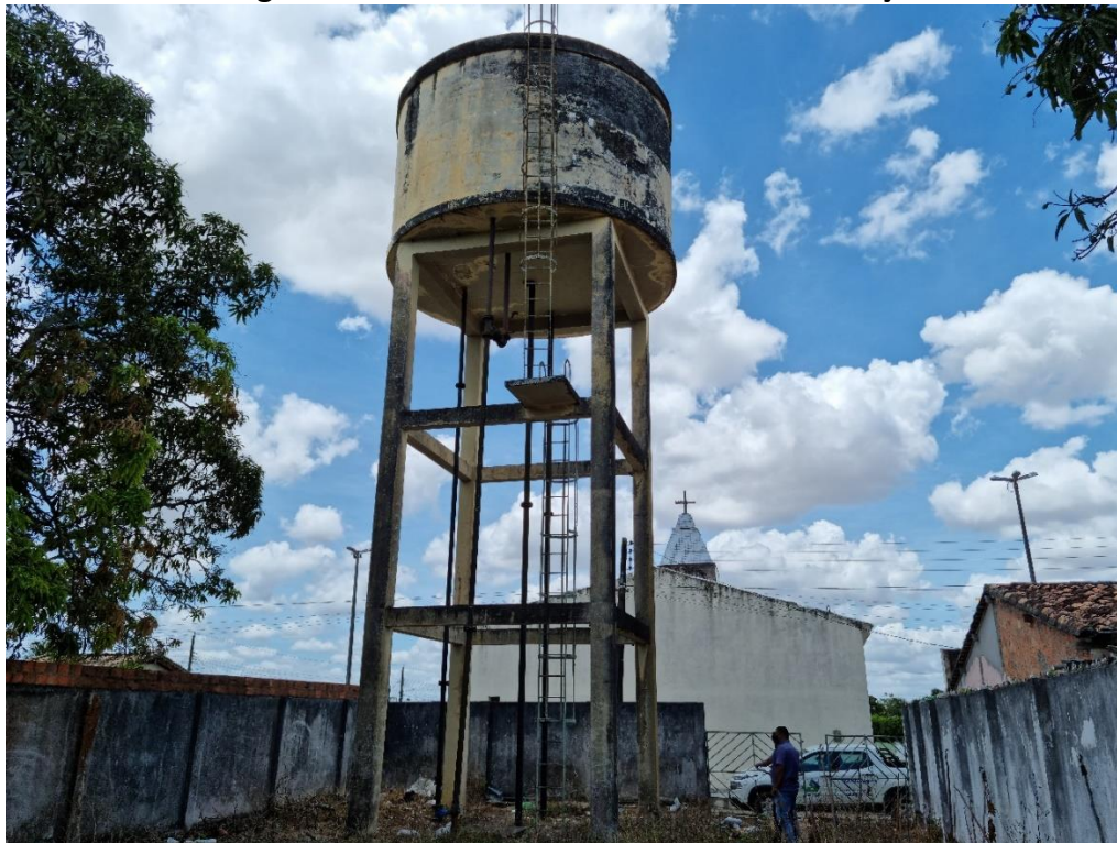
Imagem 3: Reservatório Elevado – Cruz das Graças.
