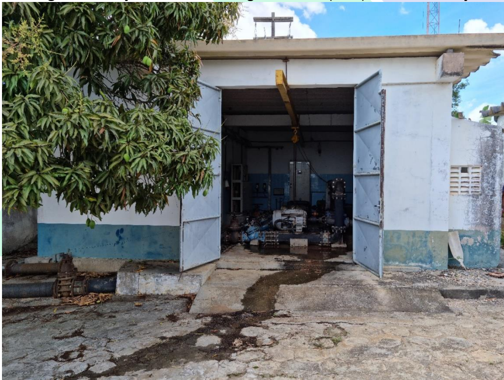
Imagem 2: Estação Elevatória de Água Tratada (EE-3) – Cruz das Graças.
