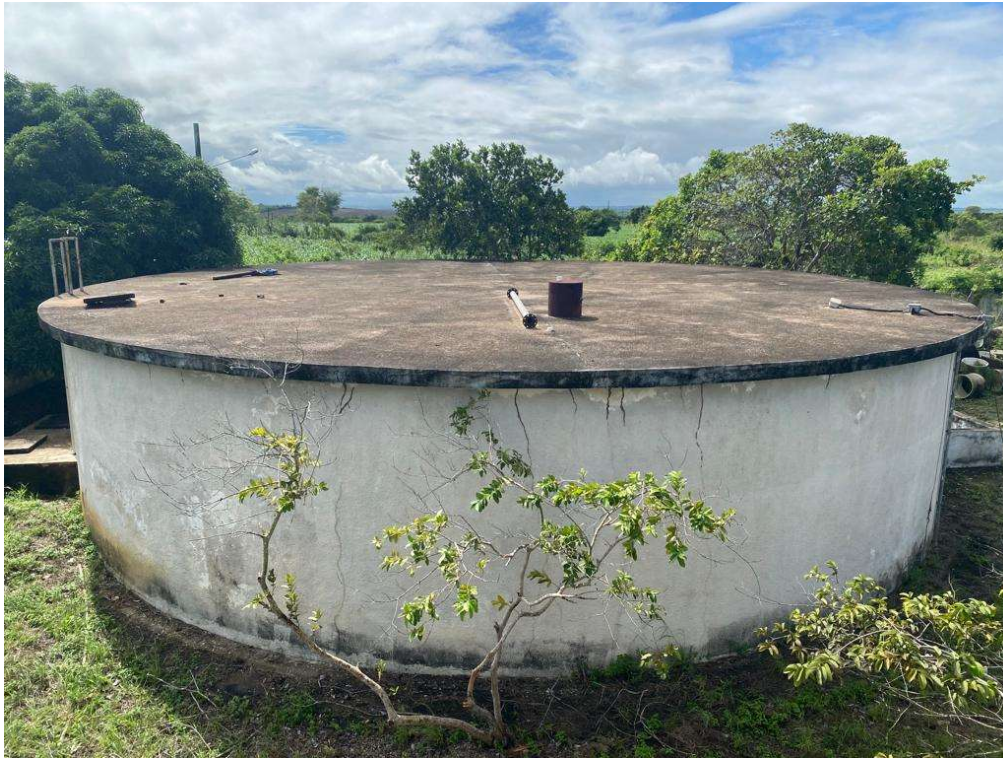
Imagem 4: Reservatório Apoiado – Área 900 – Feira Nova.
