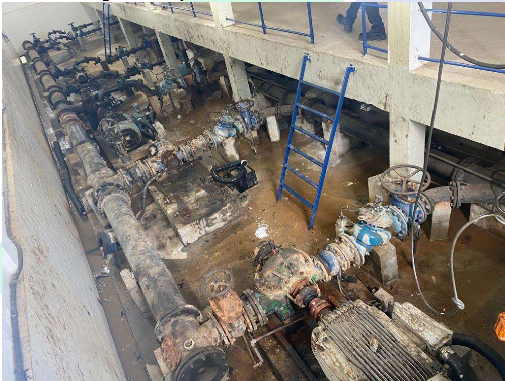
Imagem 5: Estação Elevatória – Área 900 – Feira Nova.
