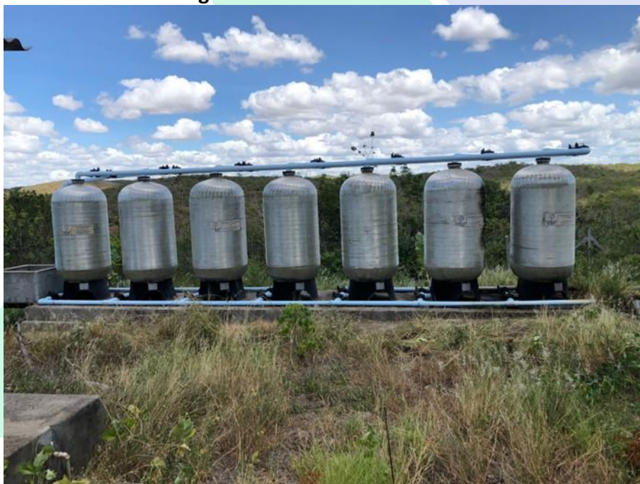
Imagem 3: Filtros – ETA Curralinho.
