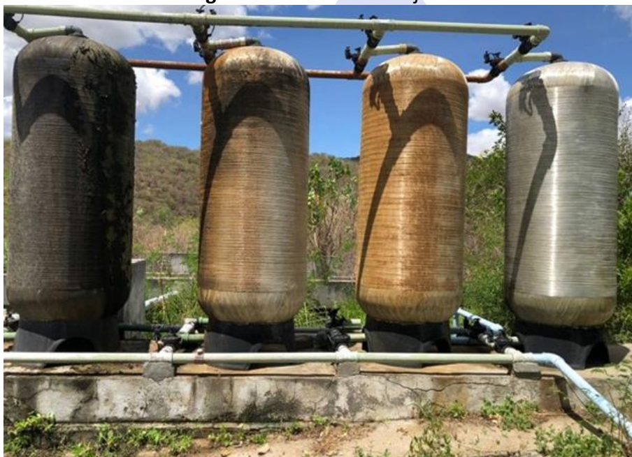
Imagem 1: Filtros – ETA Cajueiro.
