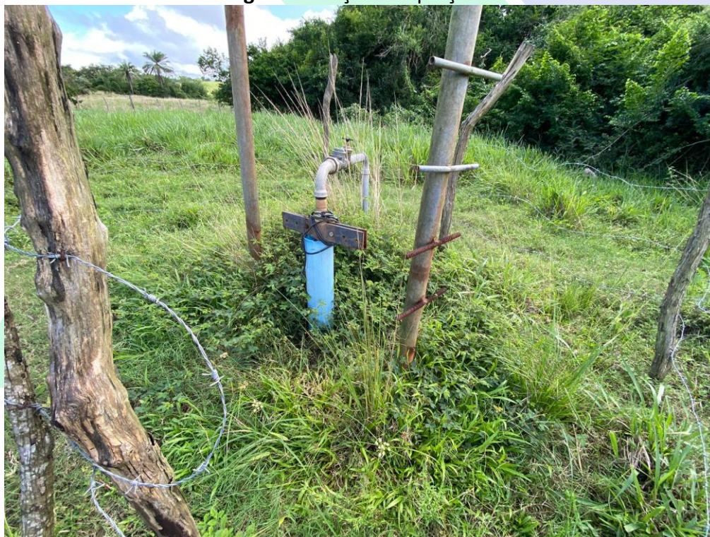
Imagem 2 - Poço de captação P2.
