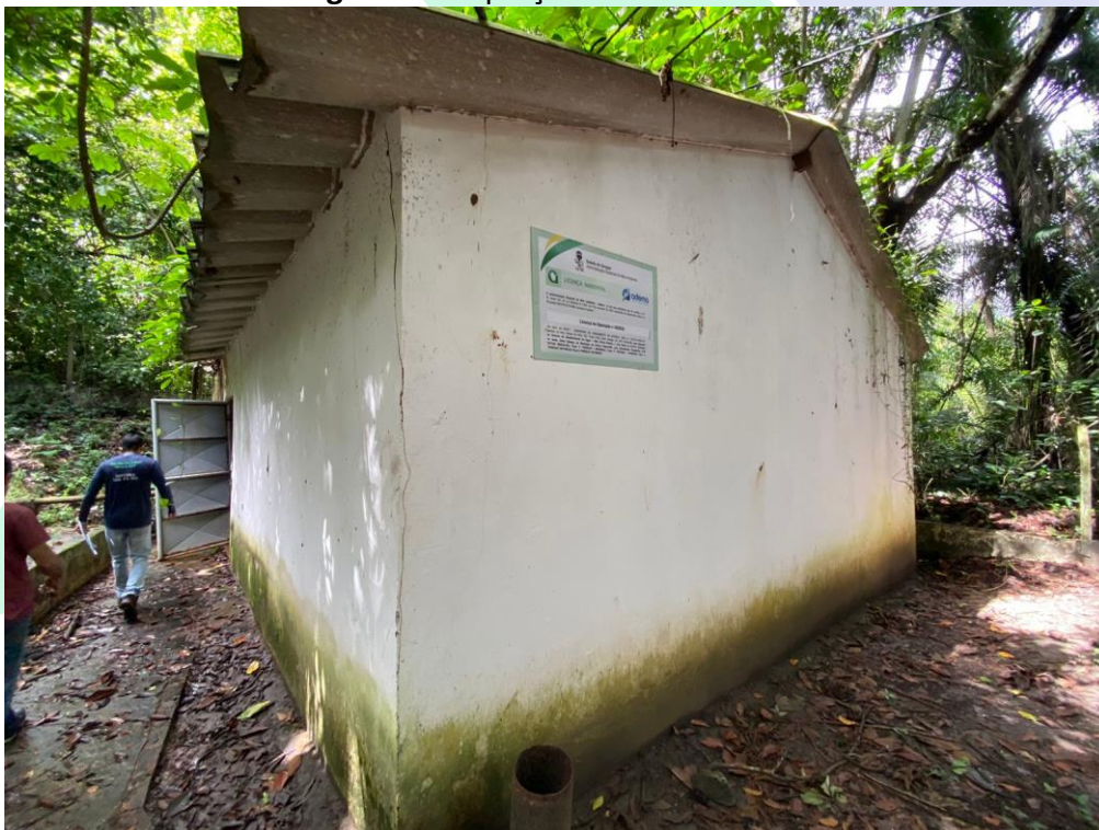
Imagem 4 – Captação Fonte dos Padres.
