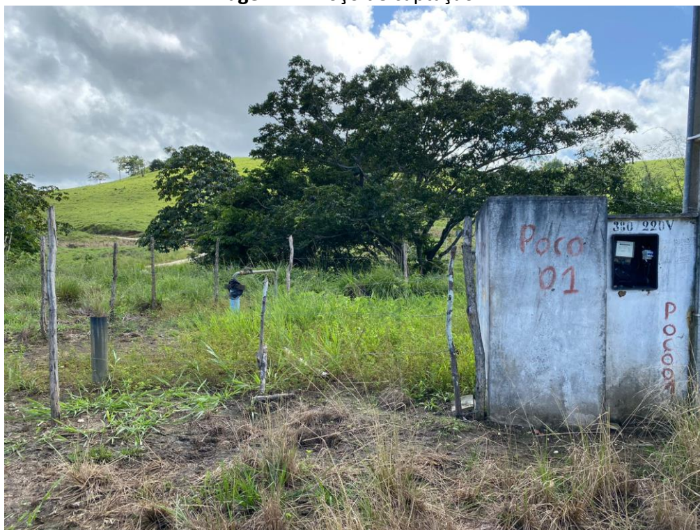
Imagem 1 – Poço de captação P1.
