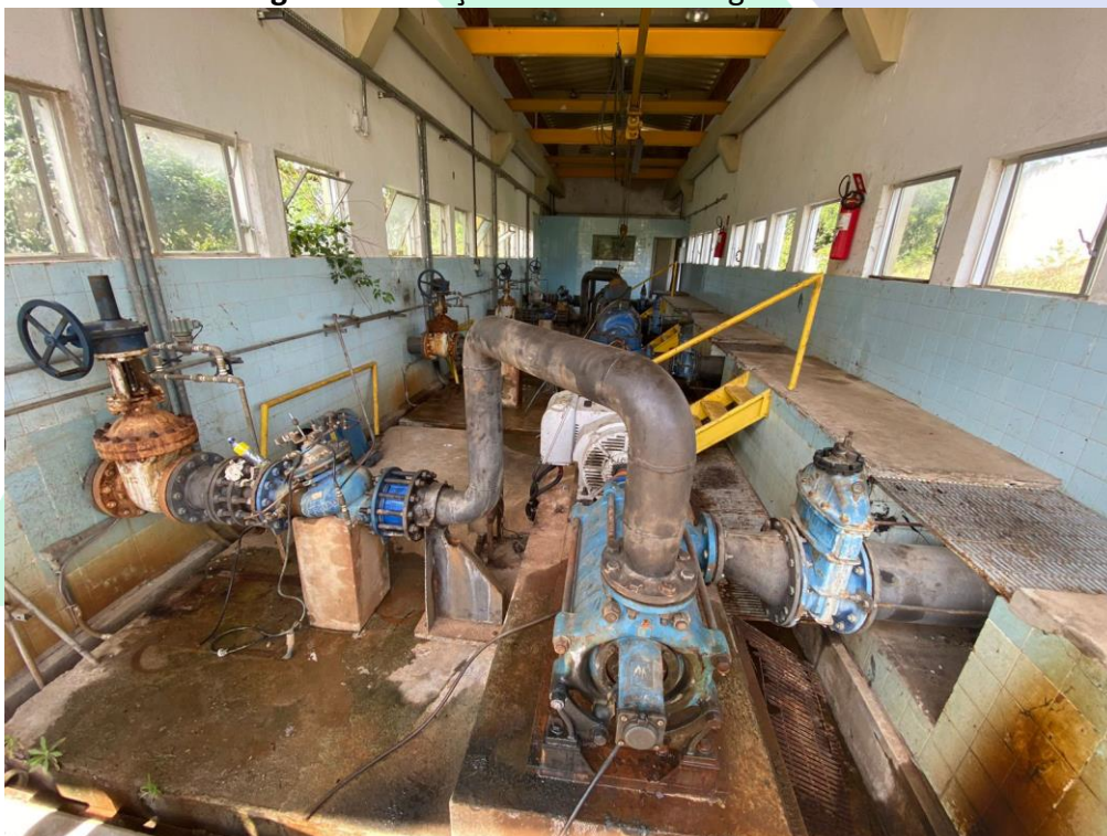
Imagem 2 – Estação Elevatória de Água Tratada.
