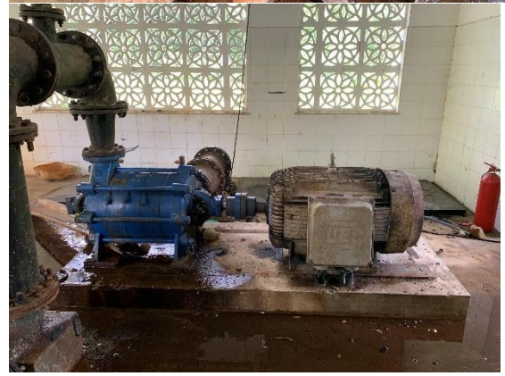
Vistas dos conjuntos elevatórios
