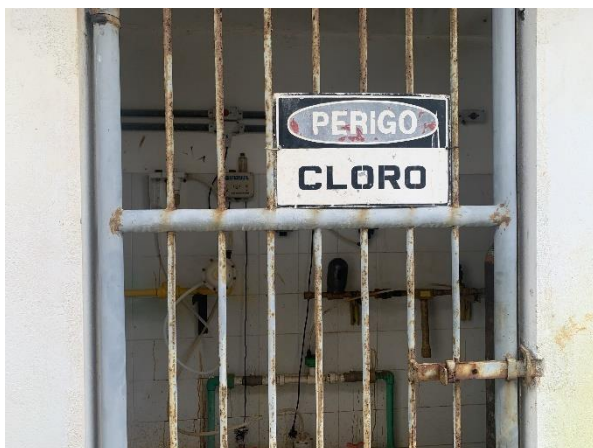
Vista externa do posto de cloração
