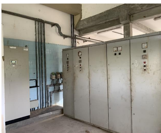
Vista dos quadros de comando dos conjuntos
