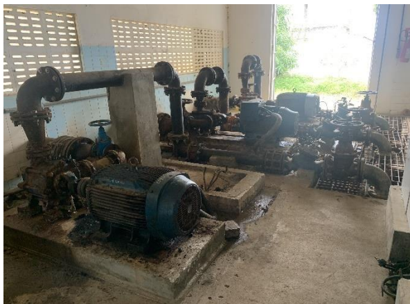
Vista geral dos conjuntos elevatórios
