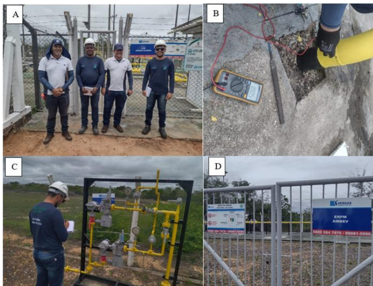
Fotos: Verificação do sistema de proteção catódica na A e B - estação de transferência de custódia (ETC) Águas Claras, C - estação de regulação de pressão e medição (ERPM) Maratá e D - estação de regulação de pressão e medição (ERPM) na Ambev
