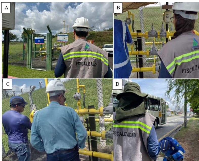
Fotos: Manutenções preditivas e preventivas - A - Substituição de medidor de vazão na estação de regulagem de pressão e medição (ERPM) Crown, B – Inspeção na rede da estação de regulagem de pressão e medição (ERPM) Maratá, C – Inspeção na Estação de Transferência de Custódia (ETC) Estância e D – Patrulha na rede de distribuição em Aracaju
