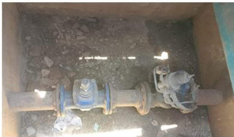
Foto 2 - VRP situada na distribuição do reservatório Morumbi, em Itabaiana
