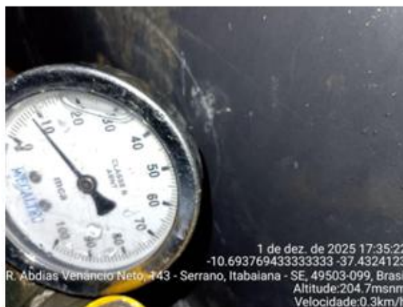
Foto 27 - Medição de pressão no bairro Serrano
