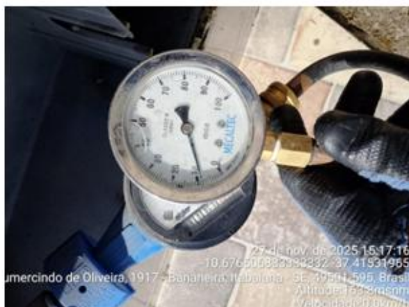
Foto 14 - Medição de pressão no bairro Bananeira
