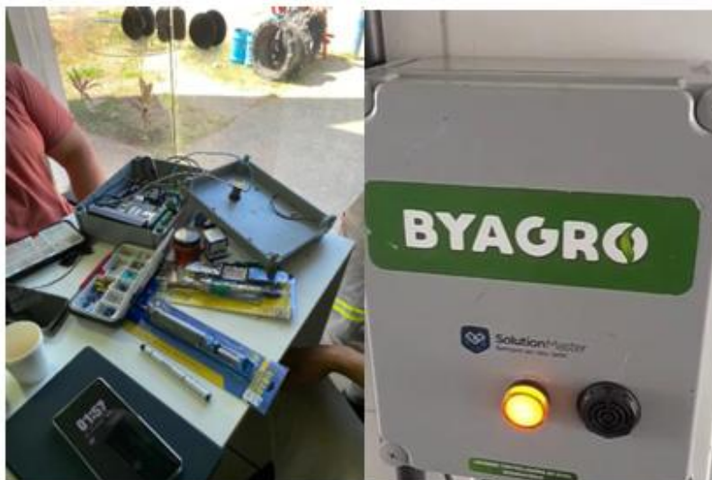
Figura 5 - Instalação de sensor de nível com alarme na UTR 4, em Areia Branca
