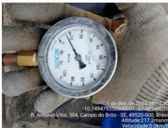
Foto 22 - Medição de Pressão em Campo do Brito
