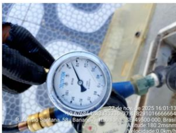
Foto 15 - Medição de Pressão no bairro Bananeira
