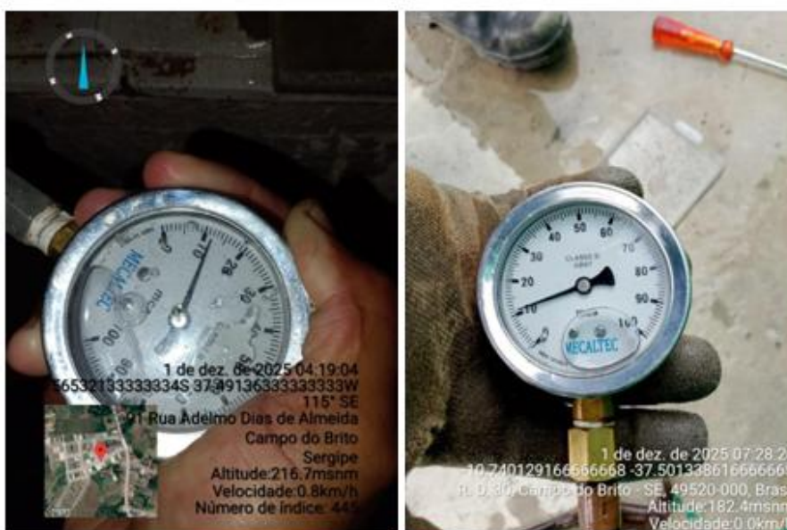
Foto 21 - Medição de pressão em Campo do Brito
