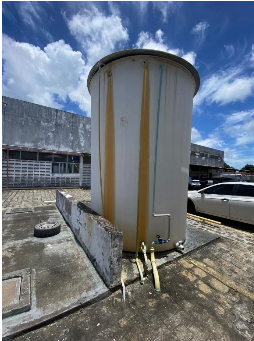
Imagem 1 – Reservatório que recebe água do poço
