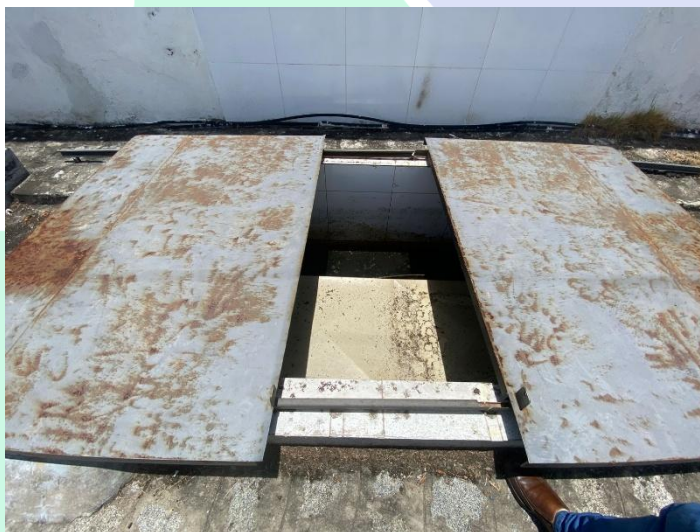
Imagem 6 – Sistema Separador de Água e Óleo, que recebe águas provenientes das lavagens dos veículos
