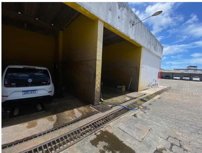
Imagem 5 – Grelhas que coletam águas de lavagens de veículos
