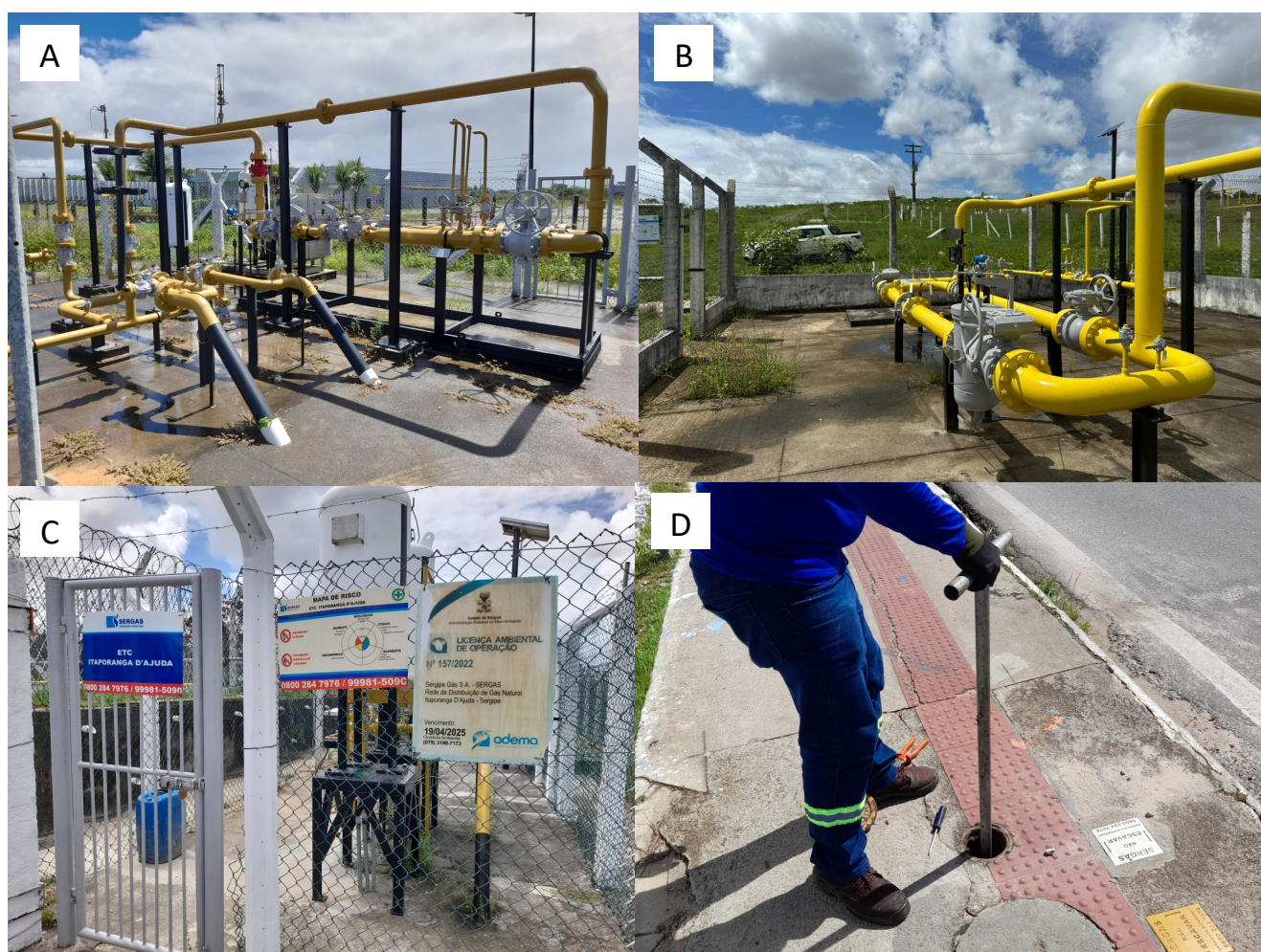
Figura 1: A– ERP DIS I e II, B - ETC Socorro, C - ETC Itaporanga e D - Teste de válvulas na rede de distribuição de Aracaju.
